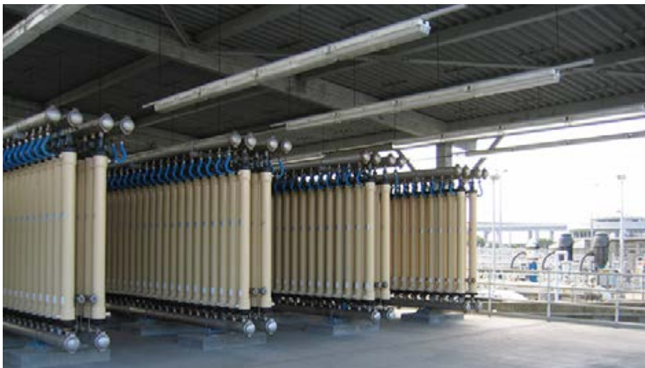
El tratamiento avanzado de aguas residuales involucra los procesos y equipos similares a los utilizados para el tratamiento de agua potable. El tratamiento avanzado se refiere a menudo como el "tratamiento terciario".
